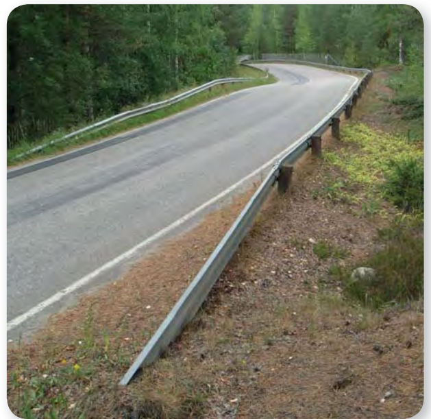
Kuva 52. Porrassalmentie pohjoispäässä on suunnitteluohjeiden mukainen teräksinen kaide.
